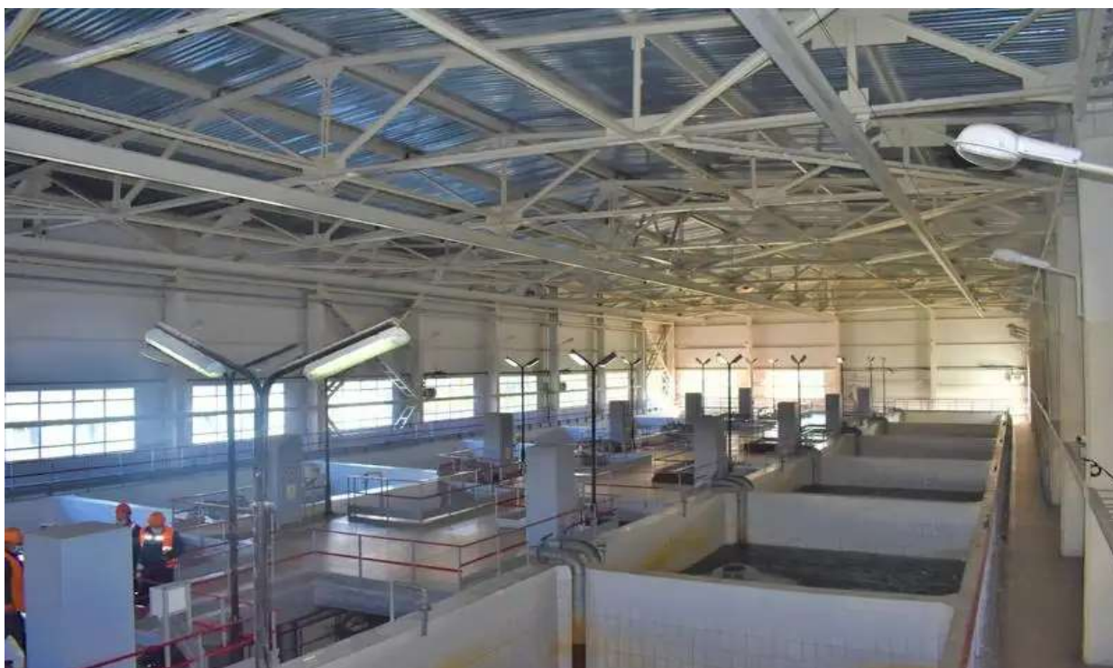
Рисунок 3 - Фильтровальная станция «Головные очистные сооружения»
